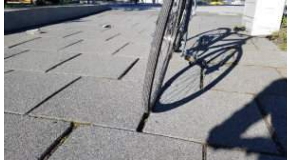
MYND 22 Aflöguð hornrétt hellurlögn sem skapar hættu fyrir hjólreiðamenn.
