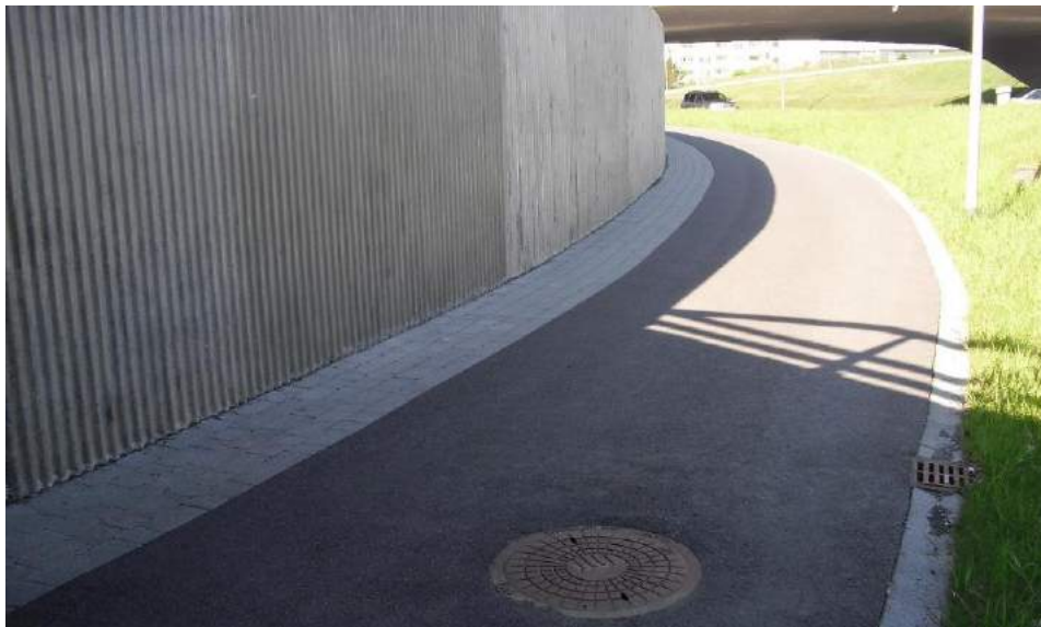
MYND 28 Sameiginlegur stígur þar sem sjónlengdir eru ekki nægjanlegar. Reykjavík við Kringlumýrarbraut.
