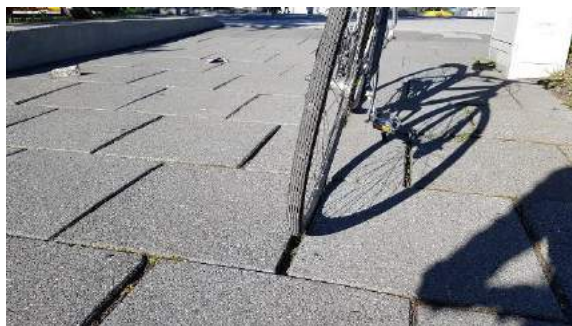
MYND 18 Aflöguð hornrétt hellurlögn sem skapar hættu fyrir hjólreiðamenn.
